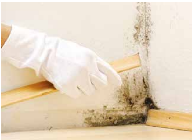
Parfois bien visibles, les moisissures peuvent aussi être cachées derrière une plinthe par exemple.
